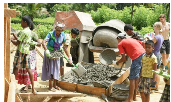
Baustelle der Papadam-Bäckerei als Teil eines Projektes der Hochschulgruppe „Engineers Without Borders“
